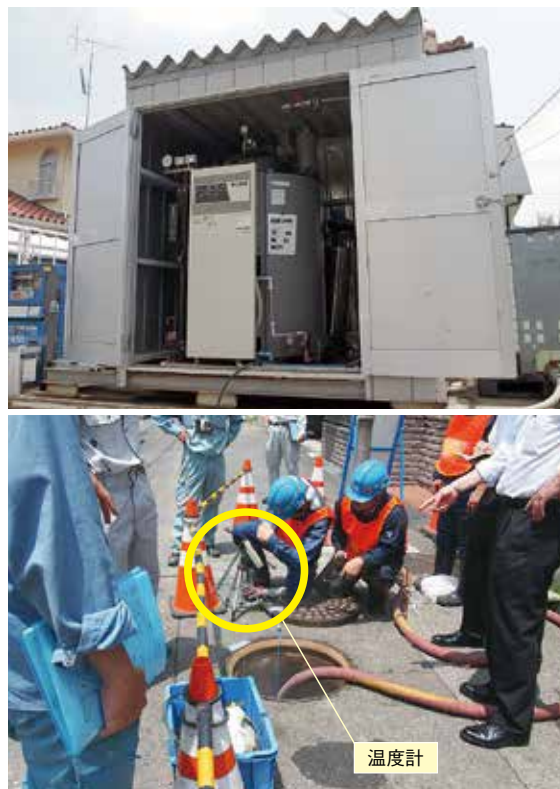
写真-5, 6 蒸気ボイラーと温度管理状況
